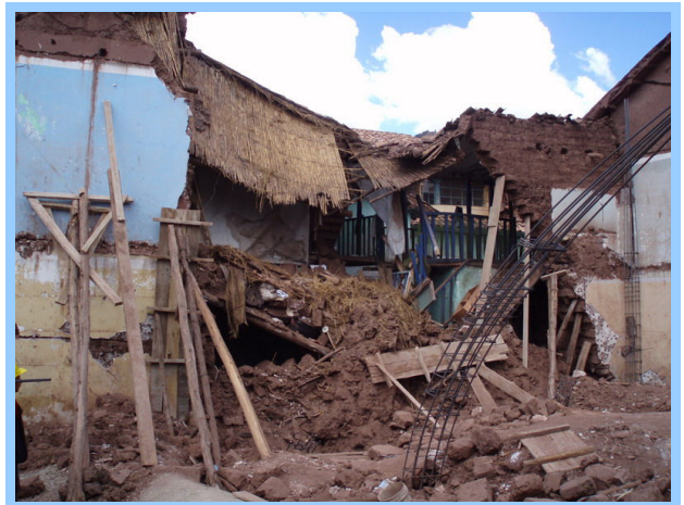
De ingestorte muur van de burens.
